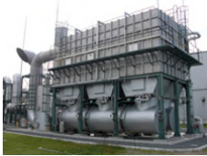
合成ゴム乾燥排気の燃焼処理設備（鹿島工場）
