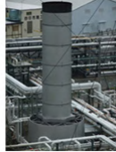
グランドフレアー（四日市工場）
